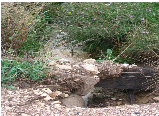
Dysfonctionnement des ouvrages, obstrués par l'envasement des dépôts provenant des terres viticoles (40)
