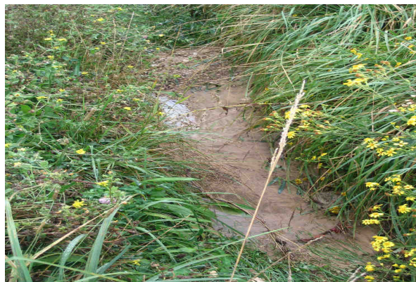
Dysfonctionnement des ouvrages, obstrués par l'envasement des dépôts provenant des terres viticoles (40)
