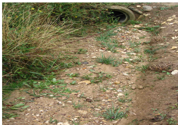
Les fossés et les réseaux d'assainissement sont obstrués sur la RD 91.
