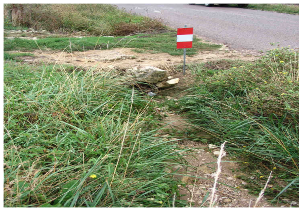
Dysfonctionnement des ouvrages, obstrués par l'envasement des dépôts provenant des terres viticoles (40)
